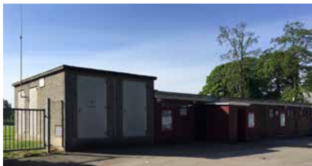
Nätstation vid entrén till Skara Arena
