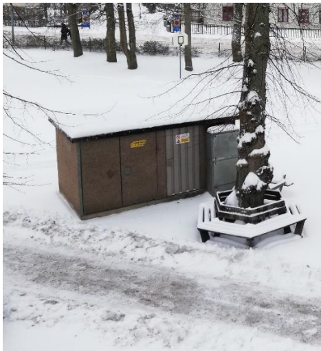
Figur 29. Transformatorstationen sedd från Paviljongens övre våning.
