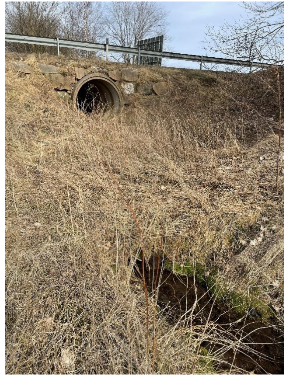
Figur 10. Större koport under riksväg 49 med mindre trumma kopplad till diket vid banvallen.
